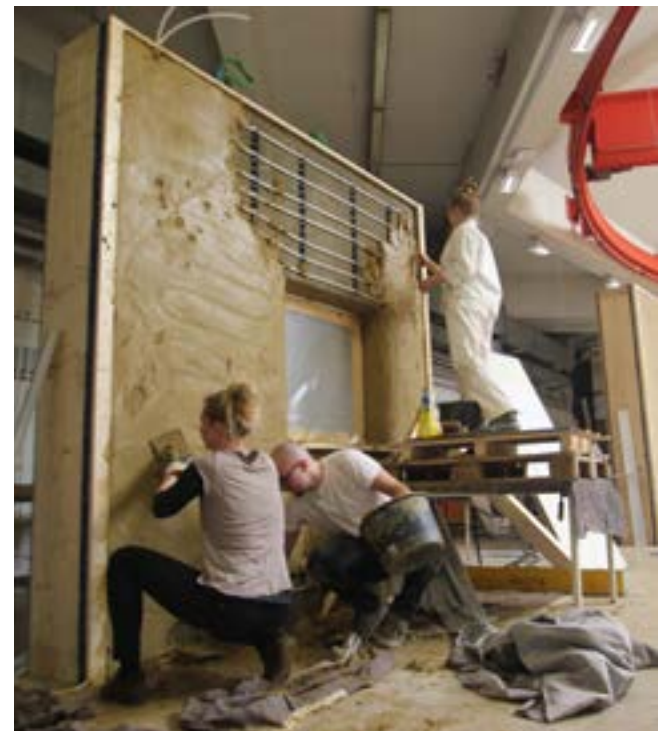
Bei einem Bauworkshop im Oktober 2019 verputzten Teilnehmende ein Fassadenelement für den dreigeschossigen Vivihouse-Prototypen mit Lehm.
